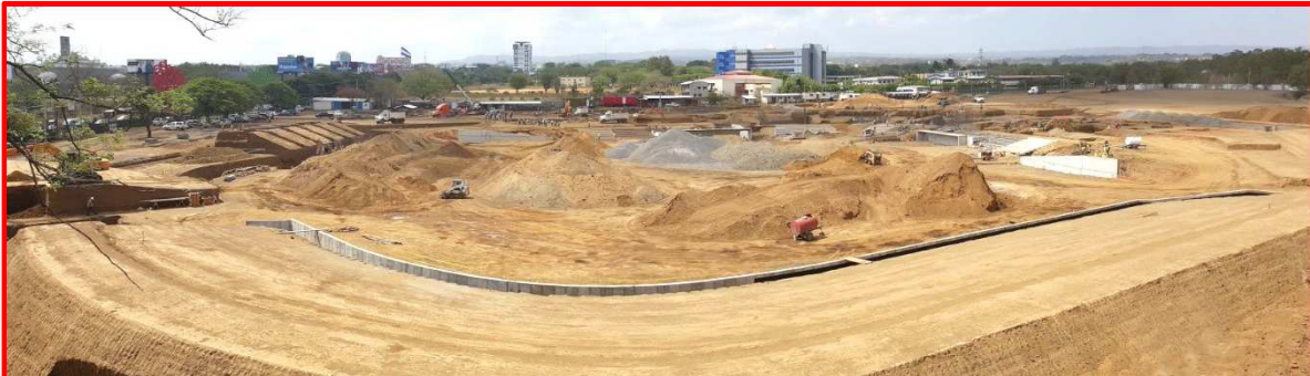
Panorámica del Trabajo de construcción de lo que será el nuevo Estadio de Béisbol de Managua.
